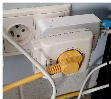
La multiprise est branchée sur le boîtier CPL
